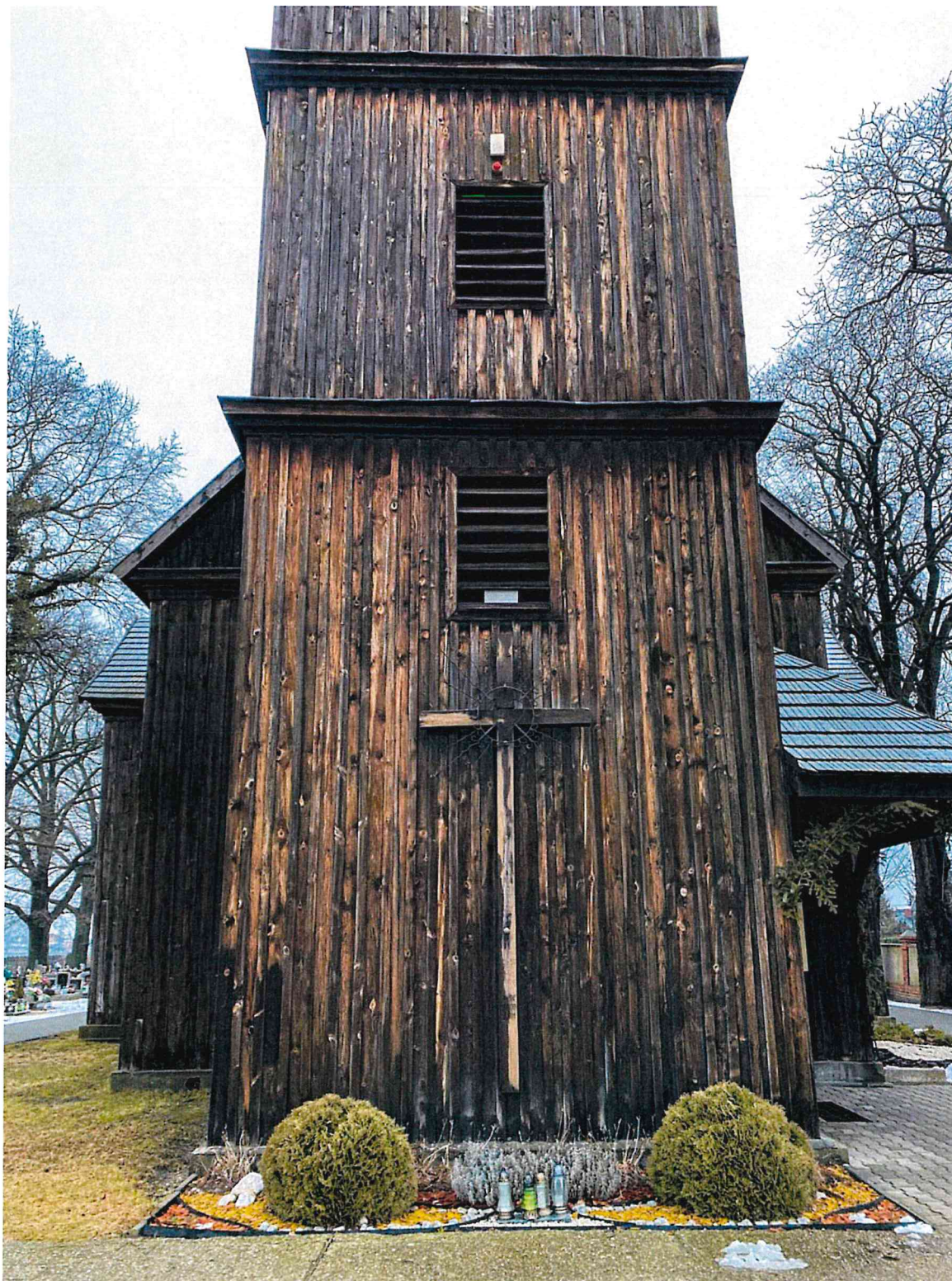
Fot.10. Wieża kościoła w Żabnie – widok szczegółowy, źródło: własne (styczeń 2023)
